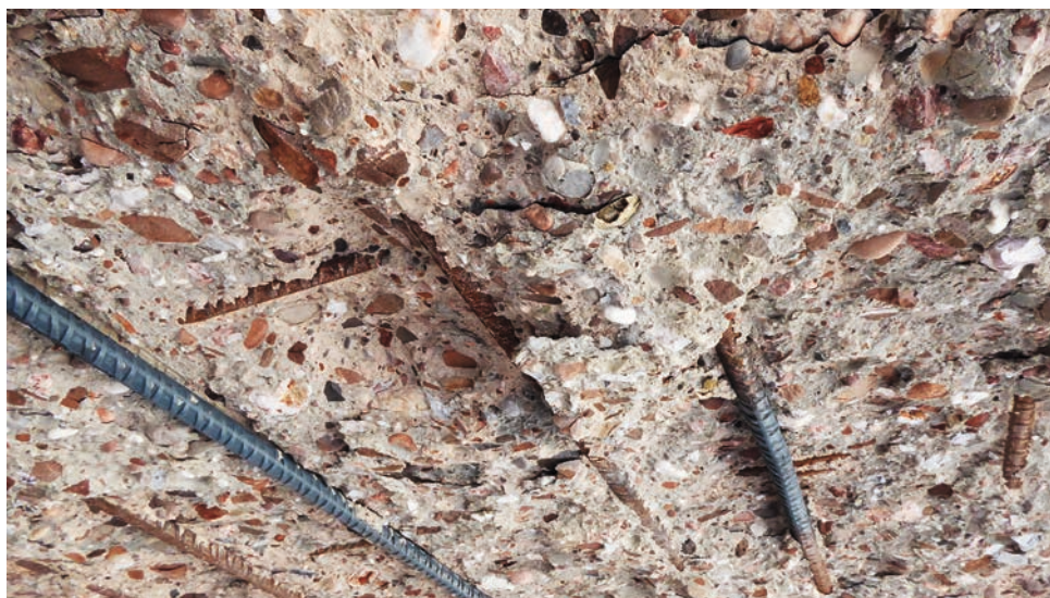
2 Als het spatten eenmaal begint, kan de wapening snel zichtbaar worden. Het betreft hier een brandproef die zoals gebruikelijk (ter bescherming van de oven) kort na het begin van het spatten is gestopt, foto: Rijkswaterstaat
