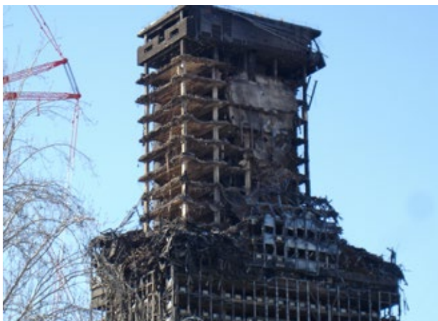
8 De Torre Windsor in Madrid na de brand in 2005. De brand begon op de 21e verdieping; na een uur stonden alle bovengelegen verdiepingen in brand, waarna de brand zich naar beneden uitbreidde. In totaal duurde de brand circa 20 uur. Vijf uur na de start van de brand stortte een groot deel van de buitenste vloeren boven de 17e verdieping in, waarschijnlijk als gevolg van het doorbuigen van de onbeschermde stalen kolommen bij de gevels. De betonnen kern, kolommen en tussenliggende vloeren presteerden zeer goed gezien de omvang en duur van de brand (foto: Wikimedia Commons)
